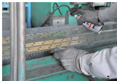
ข้อมการป้องกันสนิมสำหรับการก่อสร้างนังร้าน
