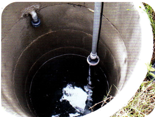
▲ การใช้งานสูบน้ำจากบ่อลึก
